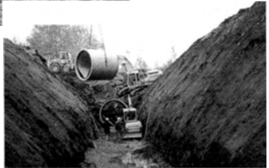
Verlegung der Rohre für den Bach durch die Neefestraße, 12. Oktober 2002, Foto: K. Butter
